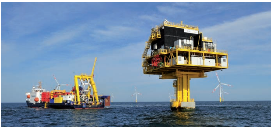
▲ Kabelleger „Aura“ neben einer Umspannwerkplattform zur Anbindung an das Netz von 50Hertz (© 50Hertz Transmission GmbH)
