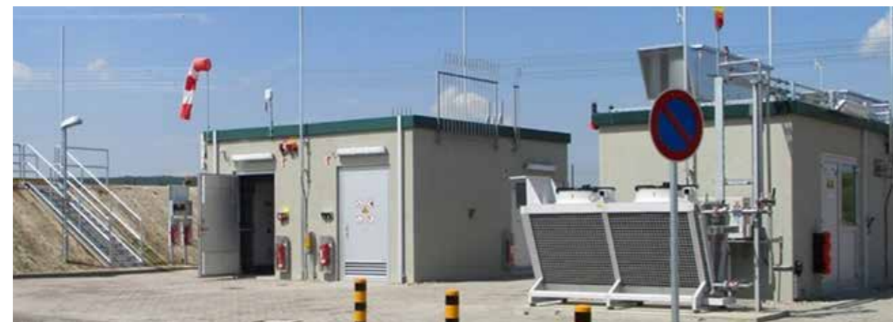
Biogaseinspeiseanlage Erdeborn (Sachsen-Anhalt) der MITNETZ Gas mbH
