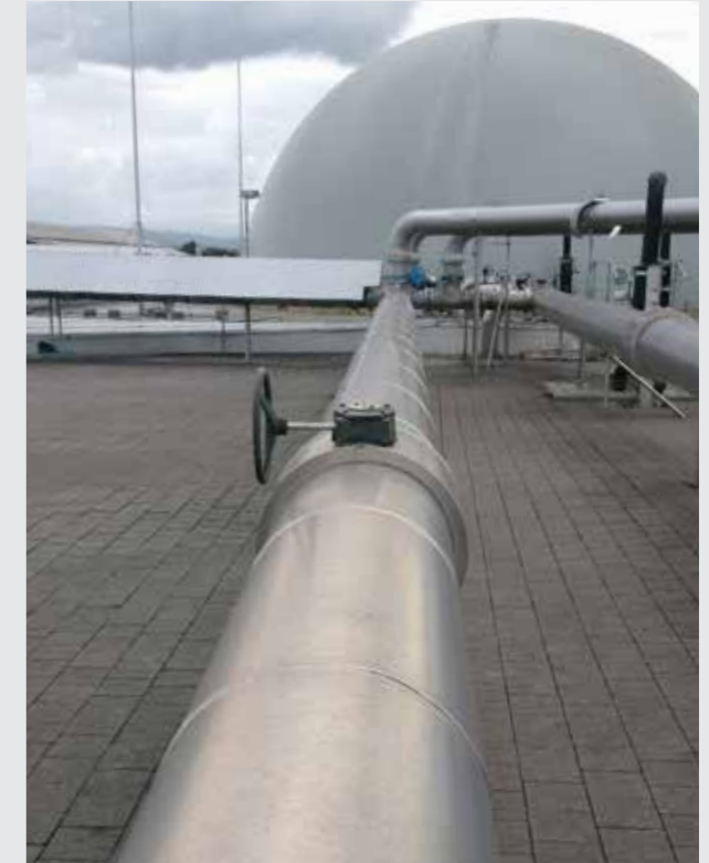
Die Auslegung der Gasleitungen und -speicher spielt bei der Planung eine wichtige Rolle (BGA Binder in Baden-Württemberg)
