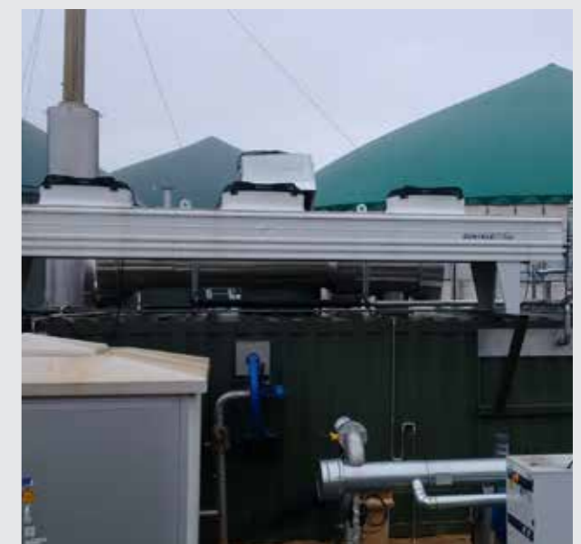
Biogasanlage Neunstadt (Baden-Württemberg) vor der Flexibilisierung
