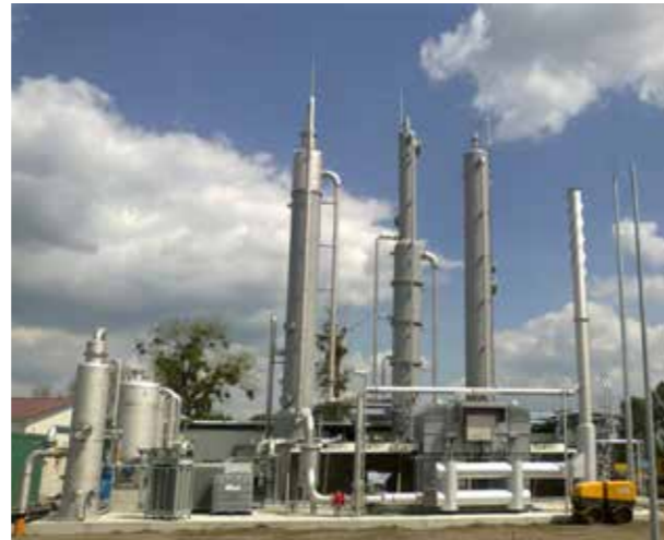
Biogasaufbereitungsanlage nach dem Verfahren der physikalisch-chemischen Wäsche
