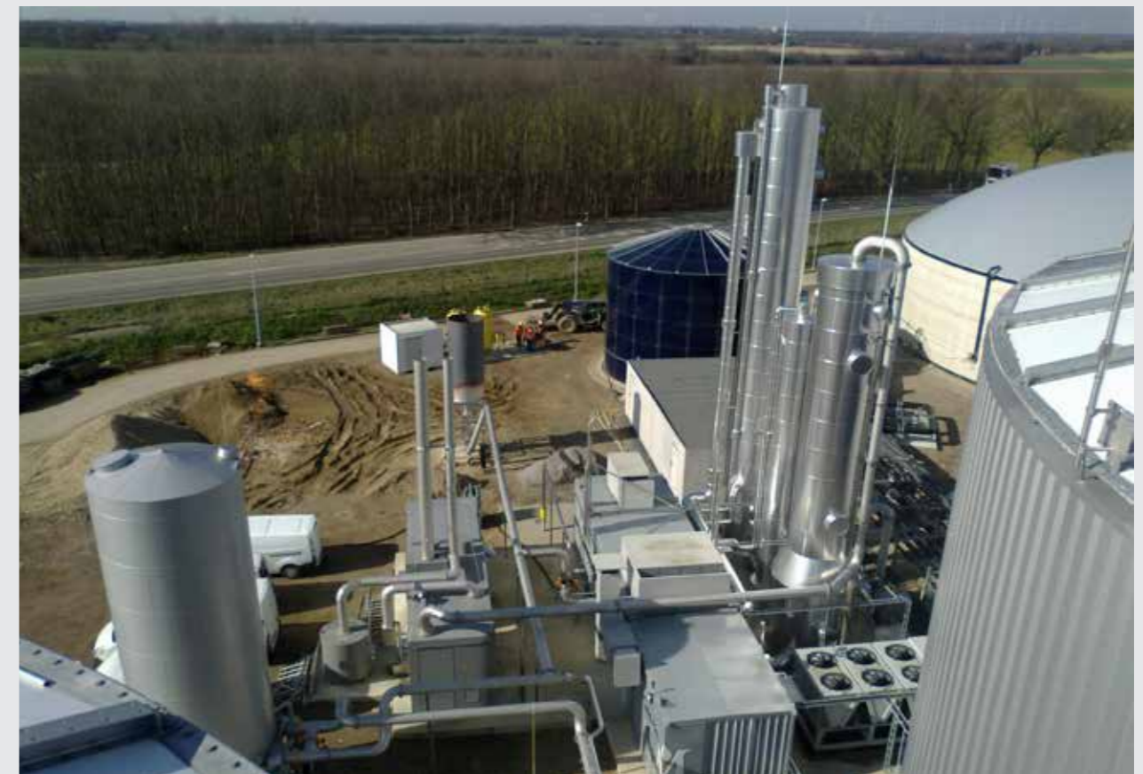
Biogasaufbereitungsanlage Bergheim-Paffendorf (Nordrhein-Westfalen)
