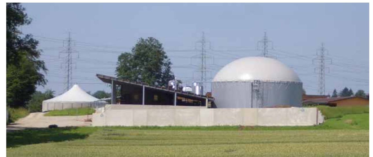
Biogasanlage Lindau (Schweiz), für die ein Explosionsschutzdokument erstellt wurde
