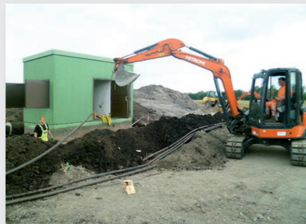
Anschluß einer Trafostation
